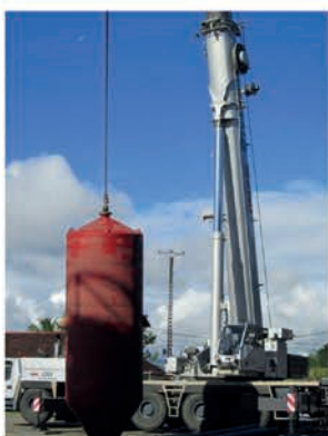
Condenseur Usine du GALION
